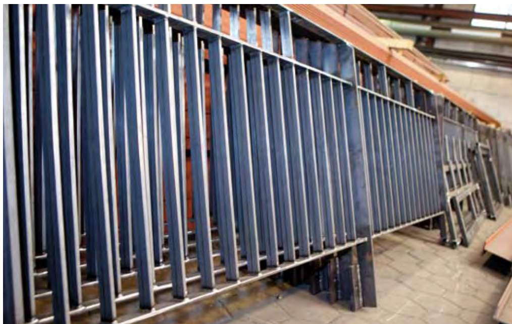
Staalbouw Berkel-Enschot maakt functionele trappen, brugleuningen en hekwerken die niet alleen veilig moeten zijn, maar ook mooi.
